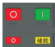
断路器断开且已储能完毕状态
