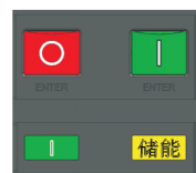
断路器合闸且已储能完毕状态
