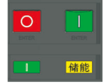
断路器合闸且已储能完毕状态
