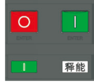
断路器合闸且无储能状态
