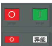
断路器断开且无储能状态
