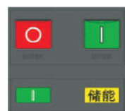
断路器合闸且已储能完毕状态
