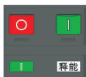
断路器合闸且无储能状态
