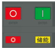
断路器断开且已储能完毕状态
