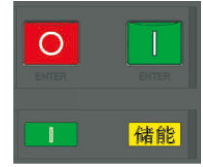
断路器合闸且已储能完毕状态
