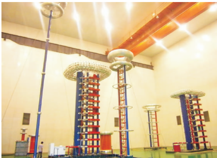
高压试验大厅
